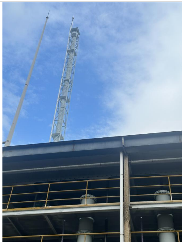
电解 2 车间 Q3 排气筒 3 组（2 级碱洗+1 级水洗）
