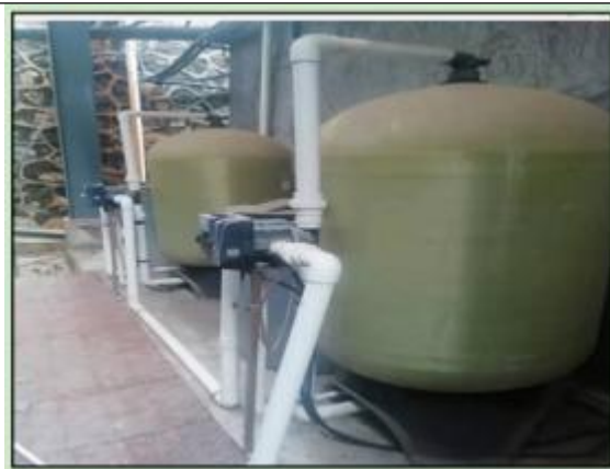
无机废水处理站石英砂过滤系统
