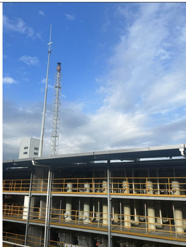
电解 1 车间水洗+碱洗及 Q1 排气筒
