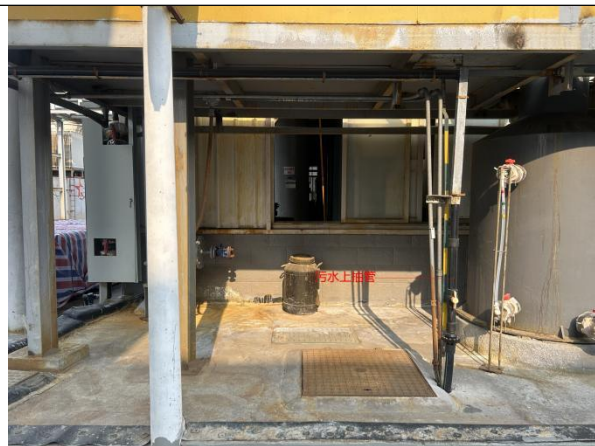
废碱液收集罐
