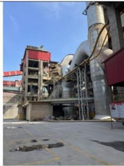
现有原料转运站
