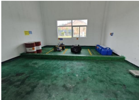
危险废物贮存间内景：防腐防渗
