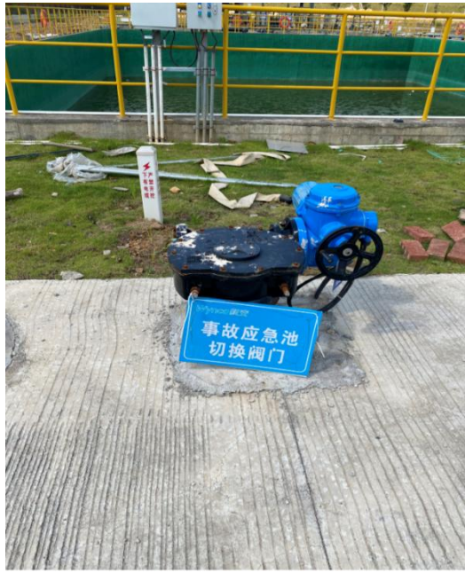
事故应急池及切换阀门
