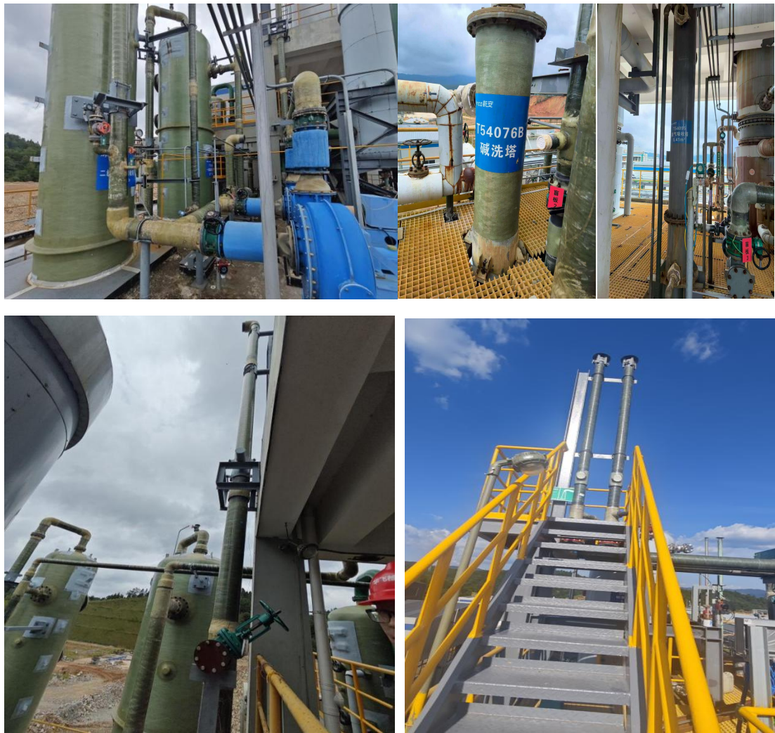
含氯废气排气筒及废气处理设施 高纯盐酸 1# 废气排气筒及废气处理设施
