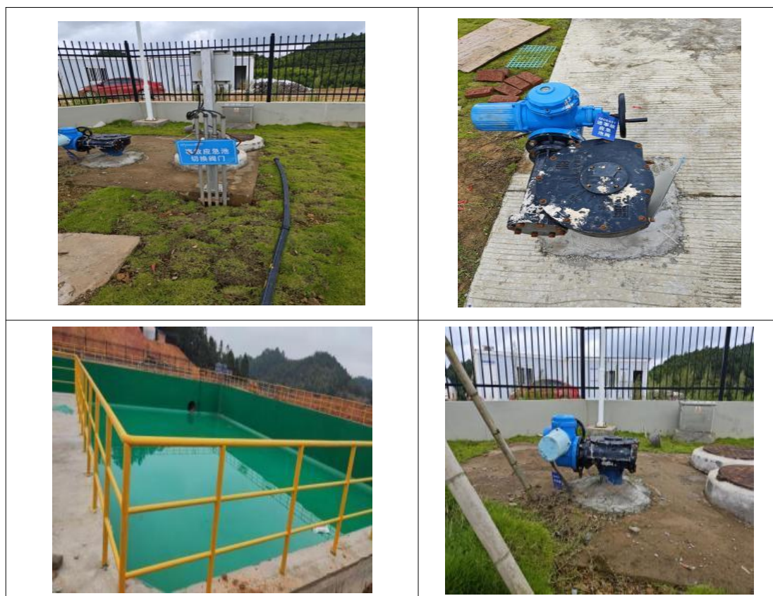
图 3.1-23 事故应急池及应急闸阀
