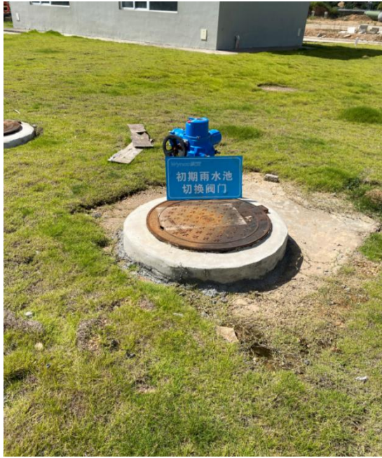
初期雨水池及切换阀门
