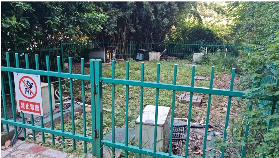
图 4-3 龙岩雁石电厂生活污水处理站现状照片
