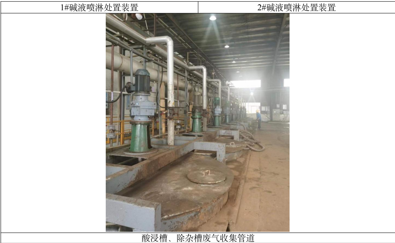
图 2.1-4 现有工程废气处理设施图
