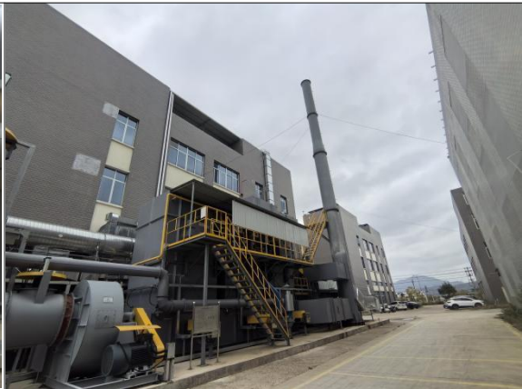
RTO 废气处理设施及排气筒
