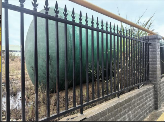
120 立方储存桶（用于临时储存事故废水）
