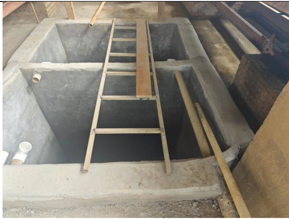
水摇床尾砂收集槽
